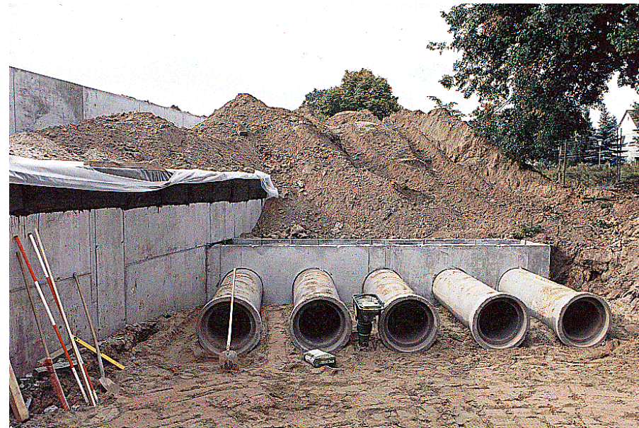
Ansaugbauwerk in Außenkeller integriert mit Verteilung
